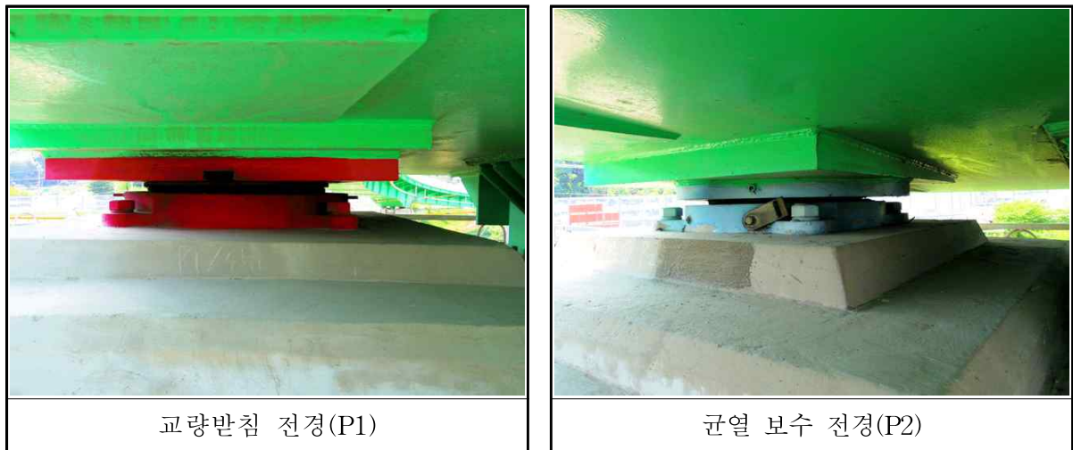
【그림 3.19】 교량받침 손상 현황
