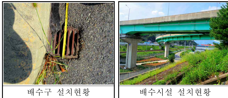
【그림 3.23】 배수시설 현황
