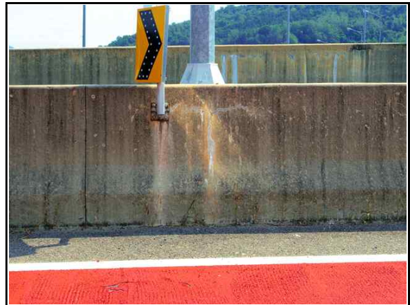
콘크리트 균열 (S1경간)
