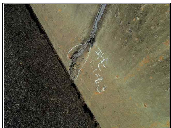
콘크리트 파손 (S3경간)
