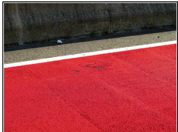
미끄럼방지 포장 파손 (S1경간)
