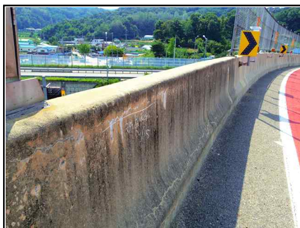
콘크리트 균열 (S2경간)
