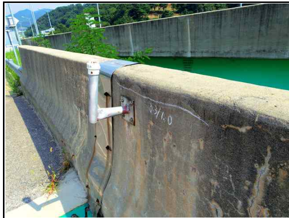
콘크리트 균열 (S1경간)
