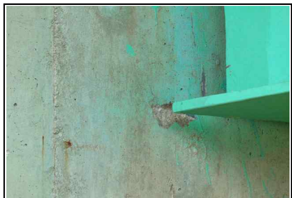
거더 및 교대(A1) 유간부족으로 인한 파손
