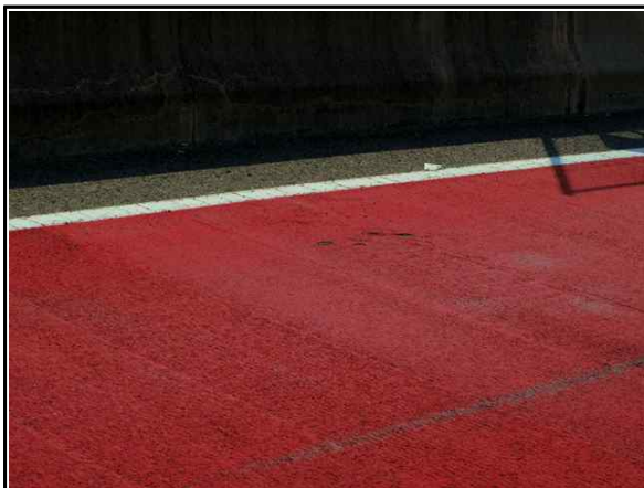
미끄럼방지 포장 파손 (S1경간)
